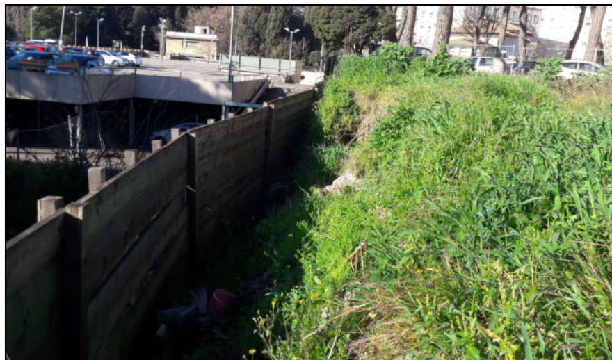
Corona del dissesto che ha determinato il crollo di parte del muro in esame
